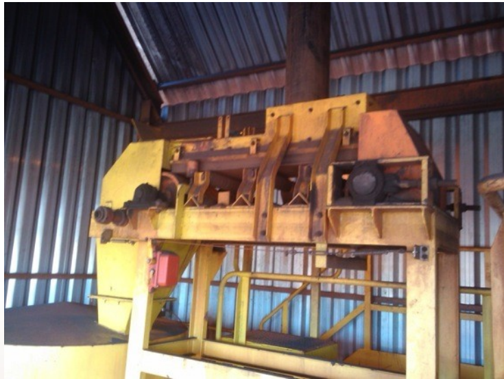
Local de instalação (Amostrador)
